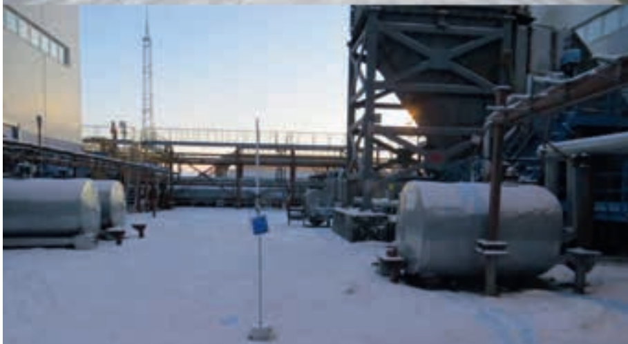
Рис. 12. Дожимная компрессорная станция нефтегазоконденсатного месторождения Юбилейное
